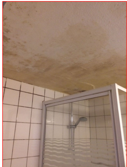
Foto 3-1: Ernstige schimmelvorming in de badkamer
