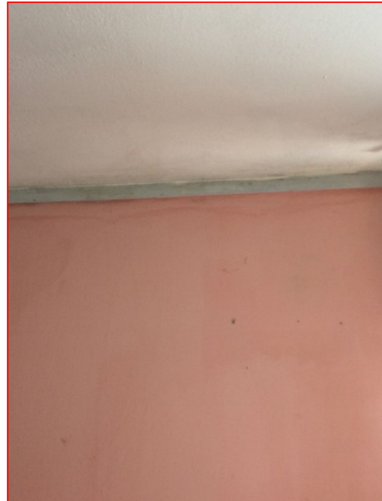
Foto 1-2: Plafond en muur zijn aangedaan door schimmelvorming
