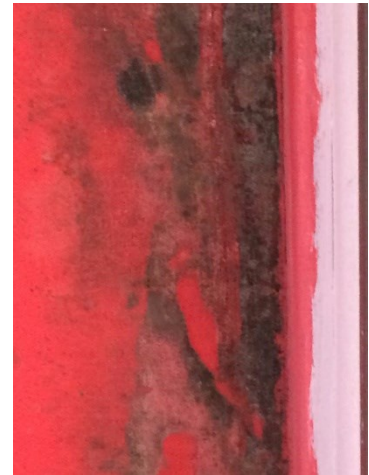
Schimmel op de muur
